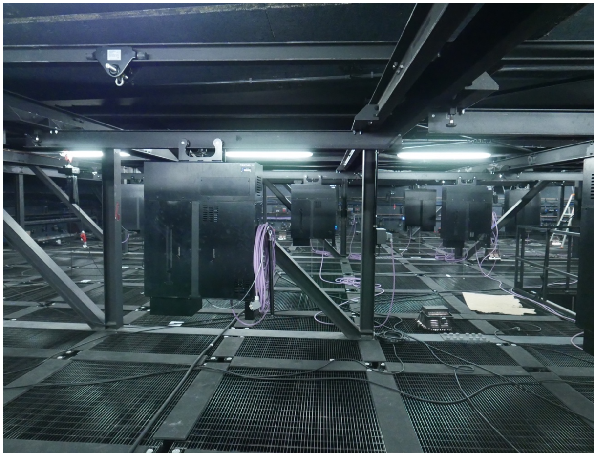
Vue du gril avec moteurs
